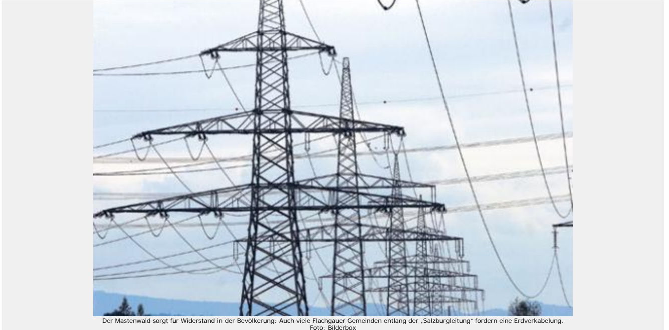
Der Mastenwald sorgt für Widerstand in der Bevölkerung: Auch viele Flachgauer Gemeinden entlang der „Salzburgleitung“ fordern eine Erdverkabelung. Foto: Bilderbox
